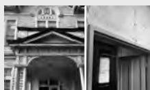
古河講堂の現状(建物全体に広がる腐朽とひび割れ)
